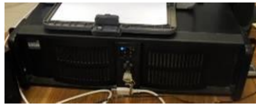
CPU CON SOFTWARE SCADA INSTALADO
